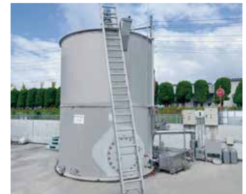
SPの事例：タマブラン (高濃度石灰乳) タンク
