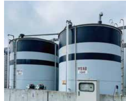
特管産廃・特管廃アルカリ受入タンク
